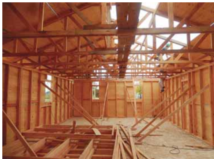
INTA Concordia construyó en 2015 una vivienda en madera en Chajarí, Entre Ríos.
